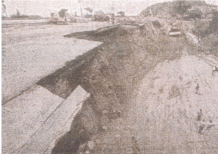
Figura 2.10 Autopista Caracas-La Guira. Falla por colapso.
