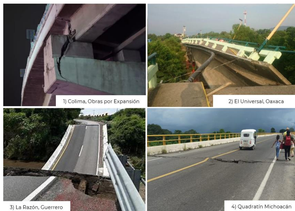
Figura 2.5 Puentes dañados por sismos
